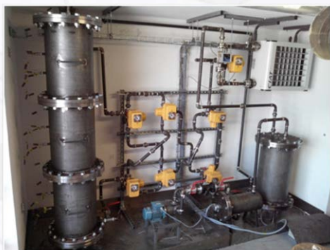
Figure 5 : Démonstrateur (avant isolation). 10 kWh de stockage correspondant à 500 kg de quartzite, HTF = huile de Colza.
