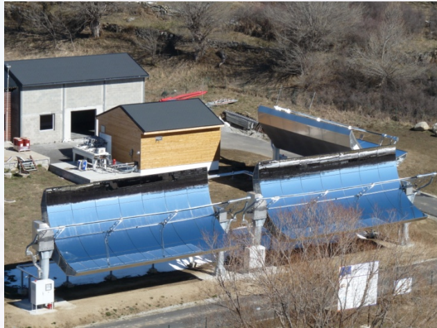
Figure 3 : Cylindro-parabolique MicroSol-R : les concentrateurs au premier plan, le bâtiment machinerie et le bâtiment atelier (en construction) derrière.
